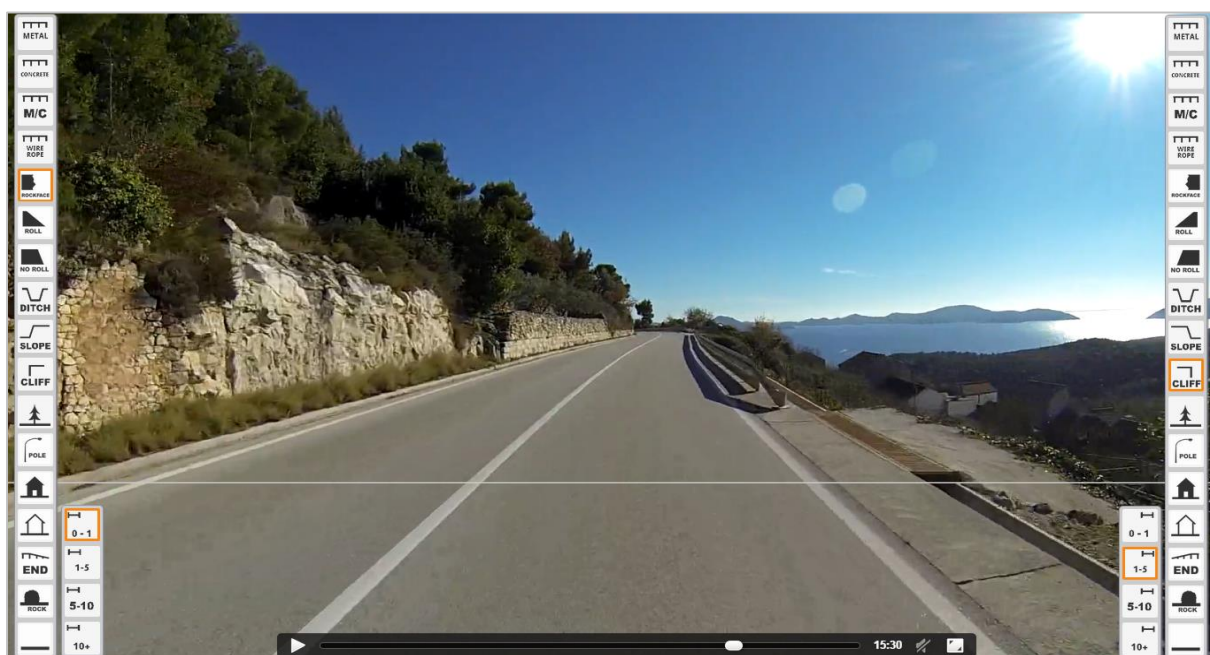
Slika 28. Primjer opasnog mjesta s provalijom i nezaštićenim početkom metalne zaštitne odbojne ograde na desnoj strani ceste
