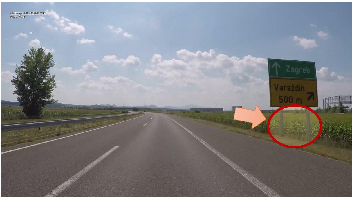
Slika 29. Primjer opasnog mjesta s nezaštićenim stupovima prometnog znaka na desnoj strani ceste, bez postavljene zaštitne odbojne ograde
