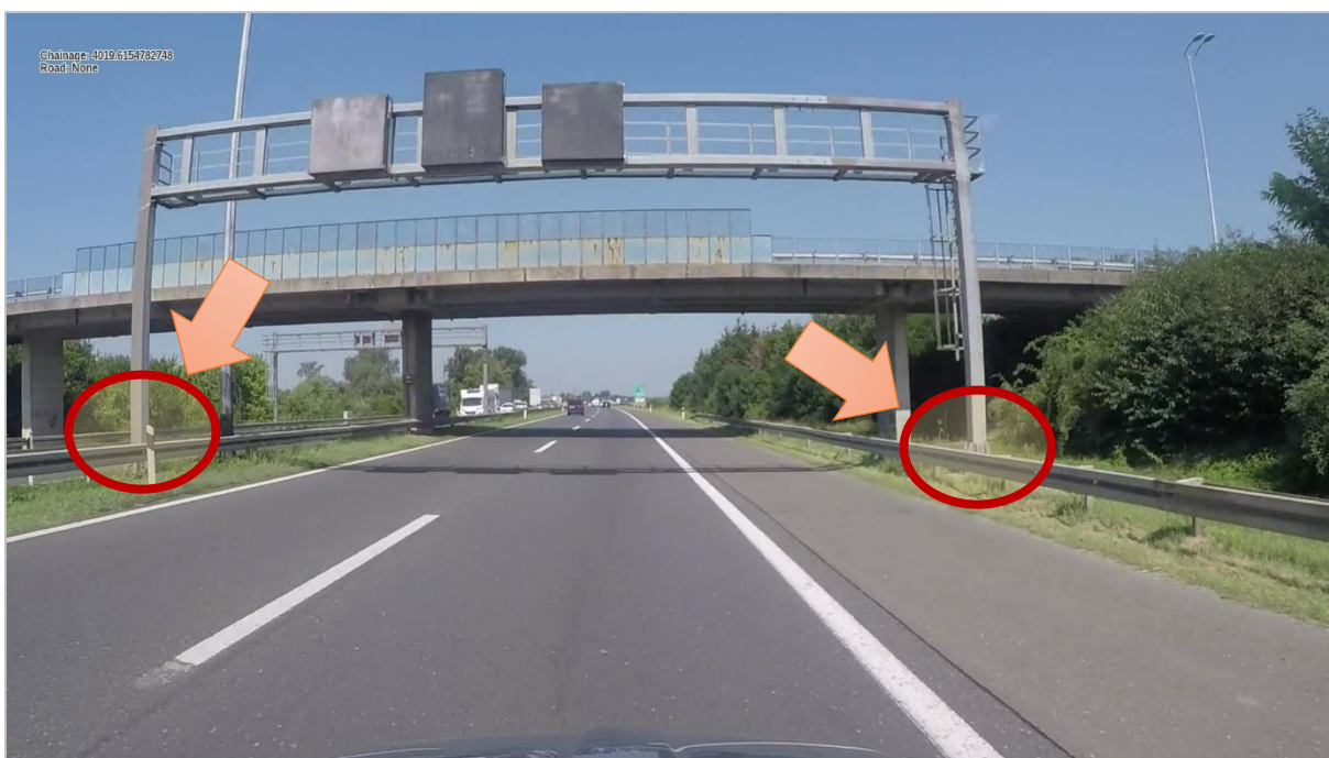
Slika 21. Primjer opasnog mjesta sa metalnom zaštitnom odbojnom ogradom postavljenu neposredno ispred stupova portala na lijevoj i desnoj strani ceste.
