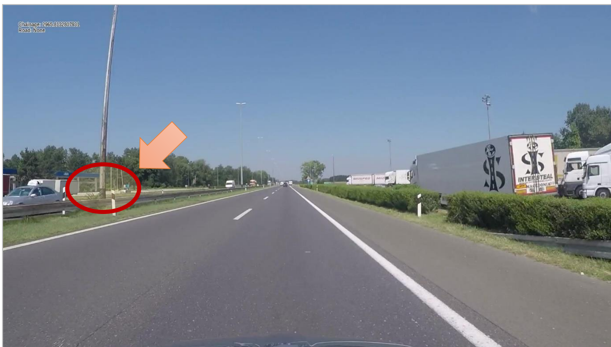
Slika 22. Primjer opasnog mjesta sa metalnom zaštitnom odbojnom ogradom postavljenom neposredno ispred stupova javne rasvjete na lijevoj strani ceste.
