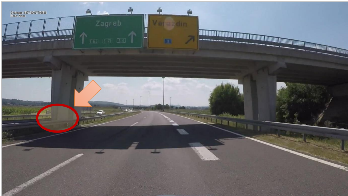
Slika 34. Primjer opasnog mjesta sa metalnom zaštitnom odbojnom ogradom postavljenom neposredno ispred stupa nadvožnjaka na lijevoj strani ceste.
