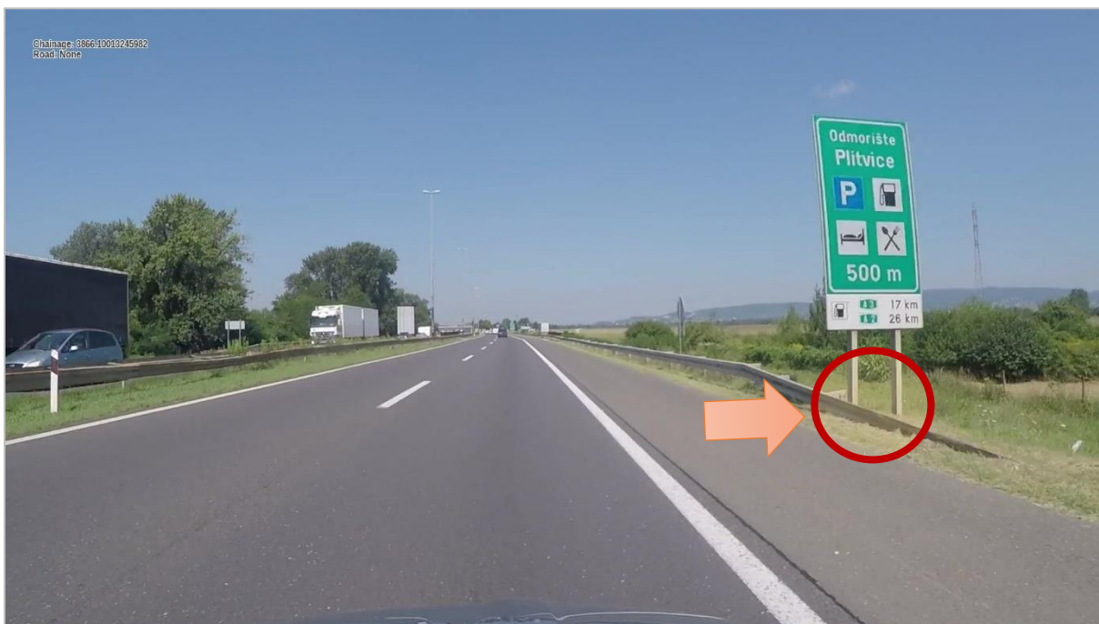
Slika 19. Primjer opasnog mjesta s nezaštićenim početkom metalne zaštitne odbojne ograde na desnoj strani ceste
