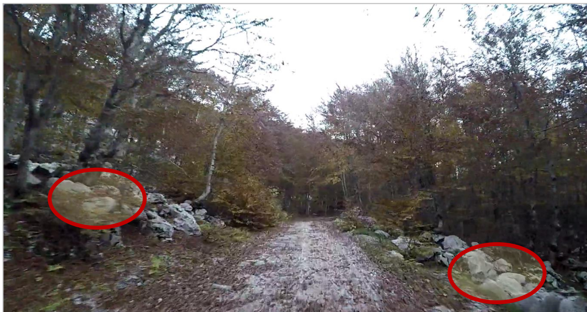
Slika 53. Primjer opasnog mjesta sa velikim kamenjem na obje strane ceste, bez postavljene zaštitne odbojne ograde (Stinica (D8) – županijska cesta ŽC5126).
